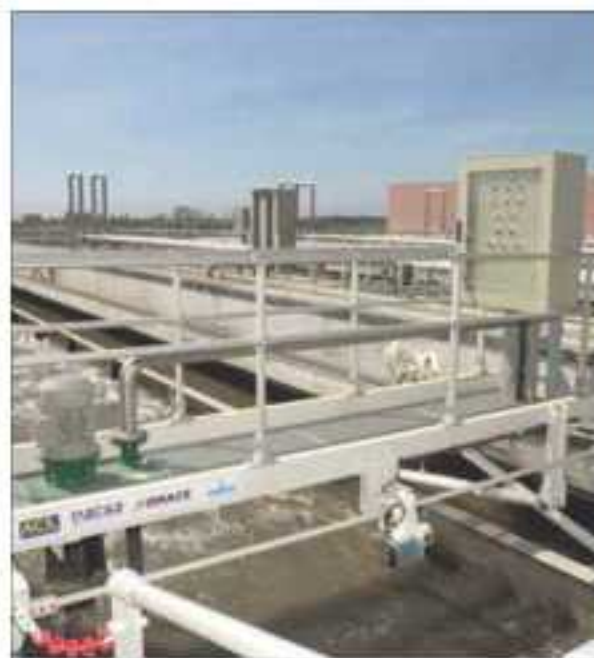
Depuradora con tratamiento biológico
