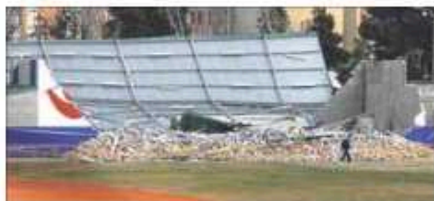
Hundimiento del túnel de bateo del estadio de béisbol de Sant Boi en el año 2009.
