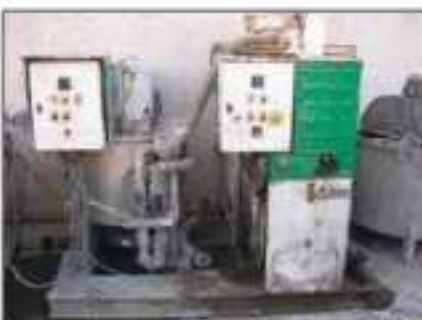
Lote 25 Planta de Inyección IPC Mod. GIET4
