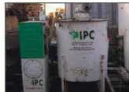
Lote 24 Planta de Inyección IPC Mod. GIET8
