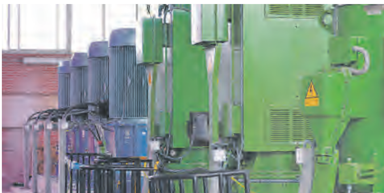
BOMBAS DE AGUA ELÉCTRICAS PARA IMPULSAR EL AGUA CAPTADA DEL RÍO A LA PLANTA DE TRATAMIENTO | I. C.
