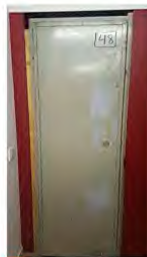
Las deficiente instalación de puertas de la Agencia Catalana de la Vivienda no impide la ocupación ilegal de las viviendas sociales
