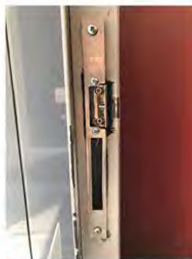
Cerraduras forzadas para ocupar las viviendas sociales
