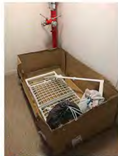
Acumulación de basuras en los rellanos
