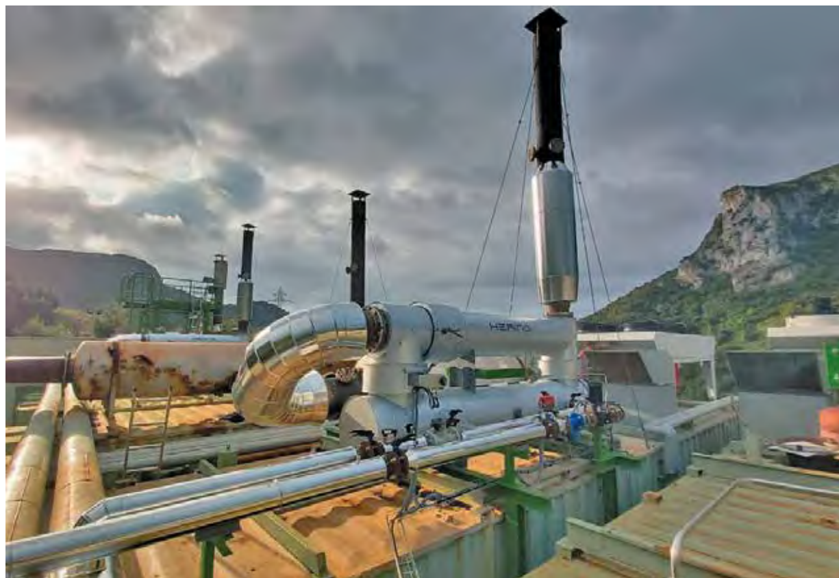
LA PLANTA DE BIOGÁS DEL ANTIGUO VERTEDERO DEL GARRAF ESTRENÓ HACE UN AÑO UN SISTEMA QUE OBTIENE ELECTRICIDAD DEL CALOR
