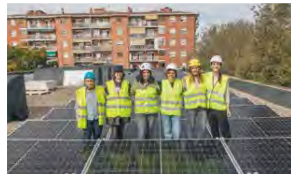
EQUIPAMENTS SOSTENIBLES: PLAQUES SOLARS A LA COBERTA DE L'ESCOLA CHARLES DARWIN DEL PRAT DE LLOBREGAT (FOTO: DIPUTACIÓ DE BARCELONA)
