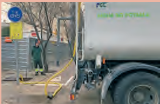
LA RED DE AGUA NO POTABLE DE VILADECANS SE ABASTECE DE POZOS
