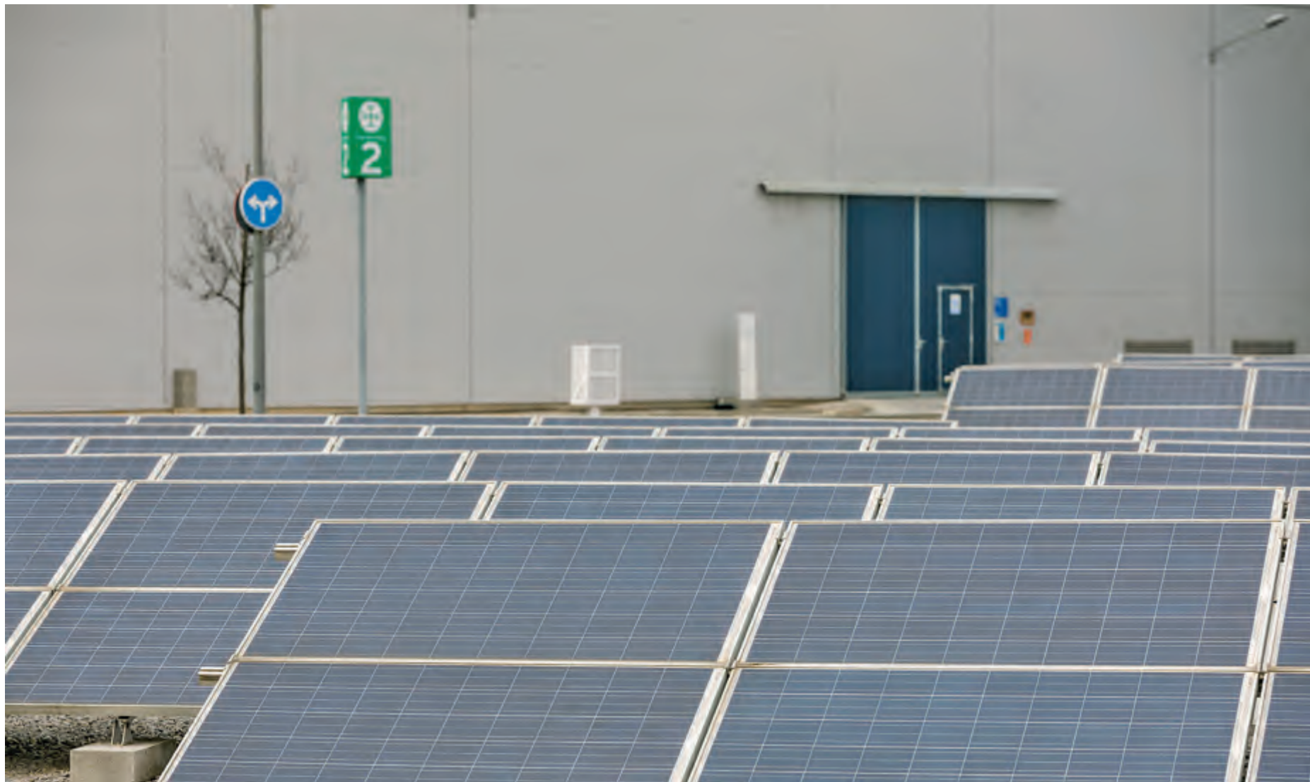
PLAQUES FOTOVOLTAIQUES COL·LOCADES A LES INSTAL·LACIONS DE L'ETAP DE SANT JOAN DESPÍ. SBTi HA VALIDAT ELS OBJECTIUS A CURT TERMINI (NEAR-TERM) I DE ZERO EMISSIONS NETES (NET-ZERO) D'AIGÜES DE BARCELONA
